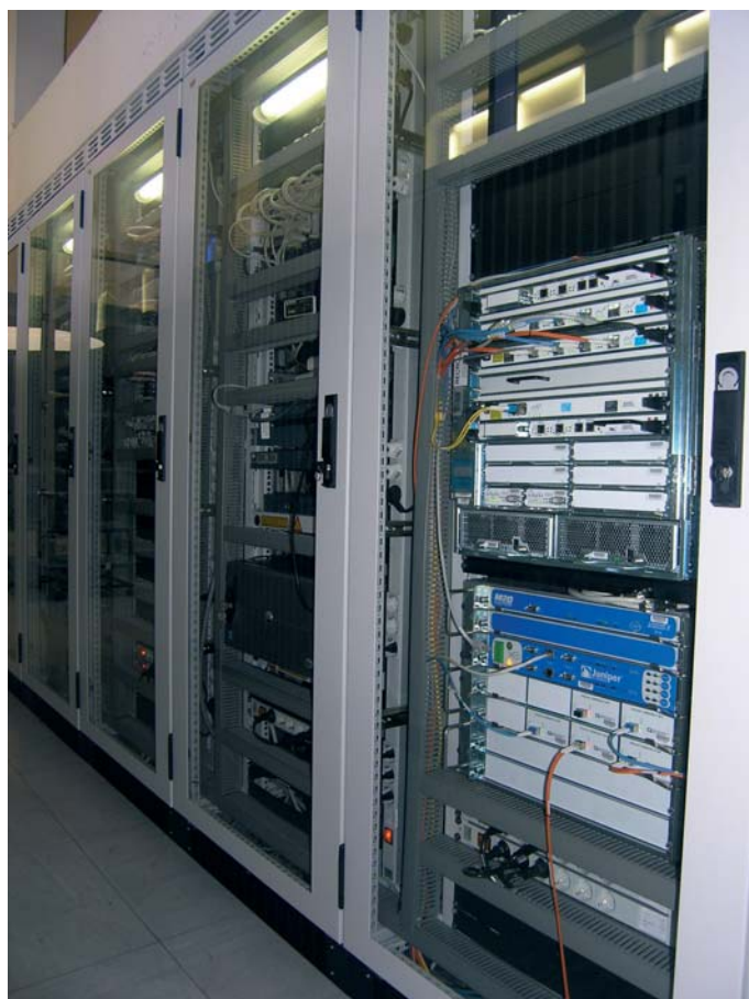
Pogled na mrežnu opremu
