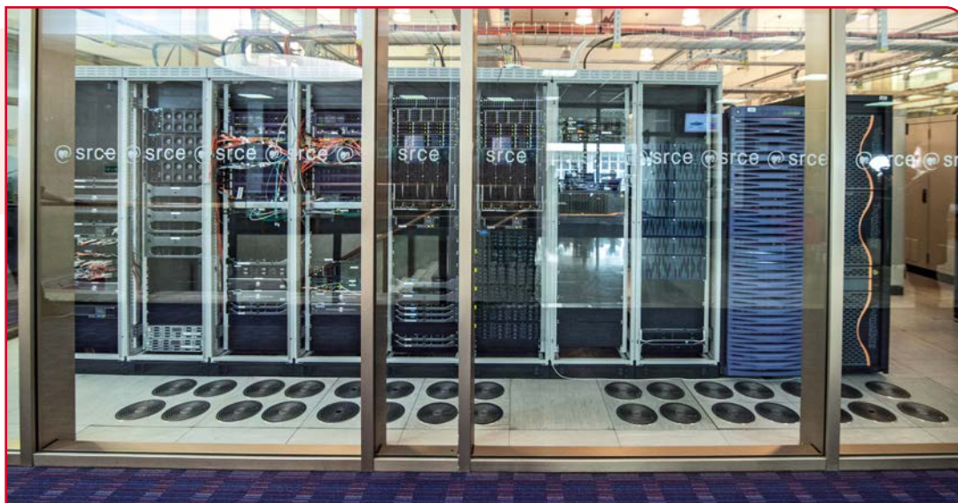
Pogled na računalnu halu u zgradi Srca, Marohnićeva 5 u Zagrebu
